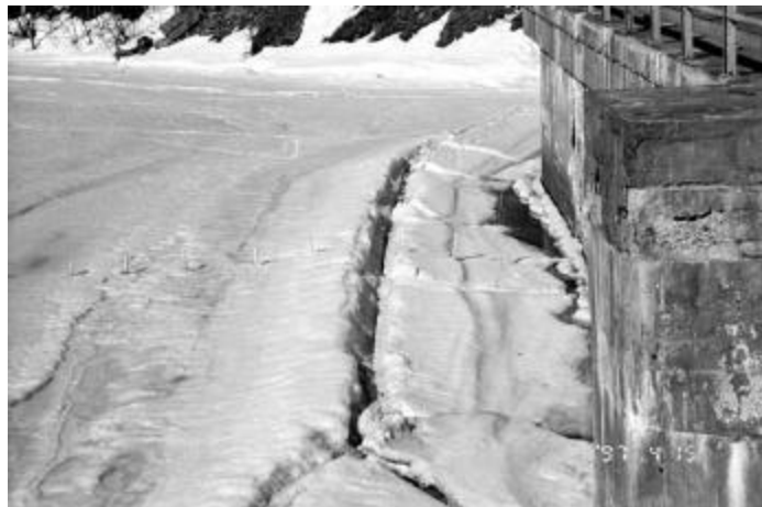
Photo 2.: Hiver 1997, Instabilité latérale du champ de glace, Barrage de La Gabelle.
